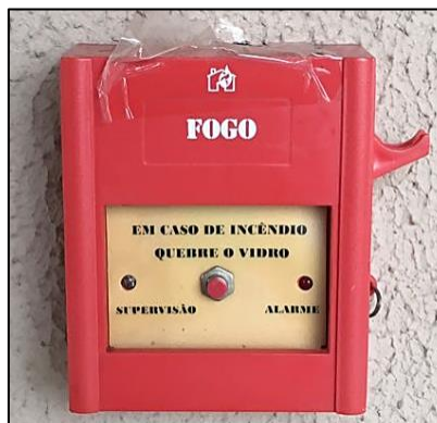
Figura 1. Sistema de alarme.
