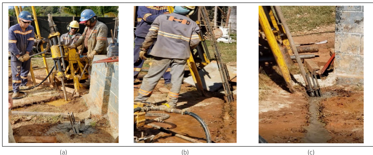
Figura 9 – Execução das estacas: (a) perfuratriz e detalhe da cabeça da estaca; (b) instalação da armadura, e (c) concretagem do furo.
