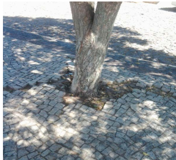
Figura 9 – Sistema radicular danificando uma calçada
