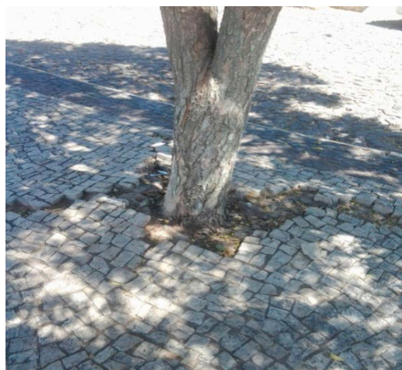
Figura 9 – Sistema radicular danificando uma calçada
