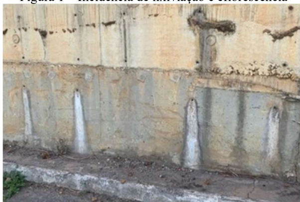
Figura 1 – Incidência de lixiviação e eflorescência
