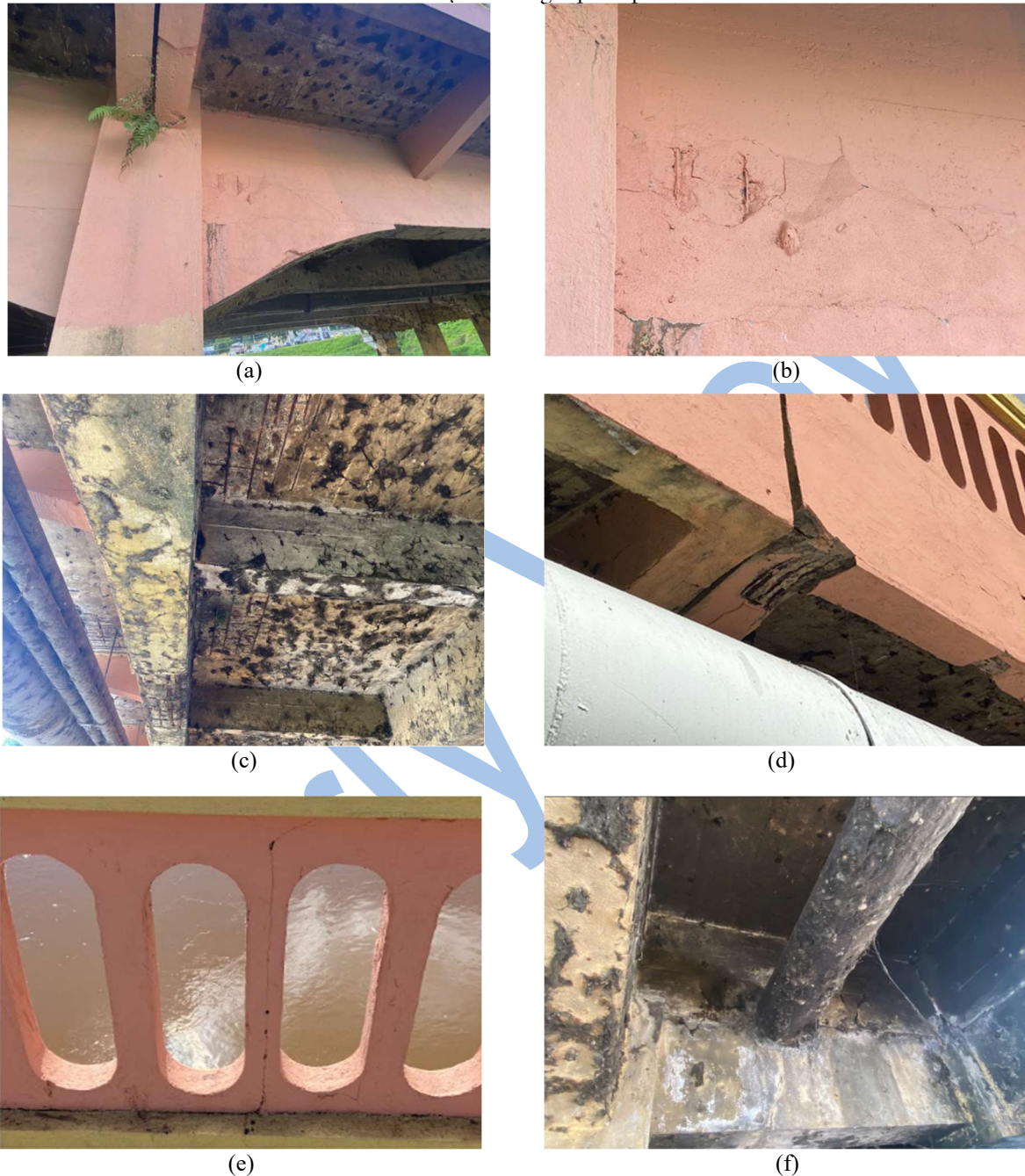
Figura 7 – Manifestações patológicas na Ponte Engenheiro Daniel Alberto Rigoli Botta: (a), (b), (c) e (d) deslocamento de concreto e corrosão da armadura nas vigas principais; (e) fissura no guarda-corpo; (f) umidade e lixiviação nas vigas principais
