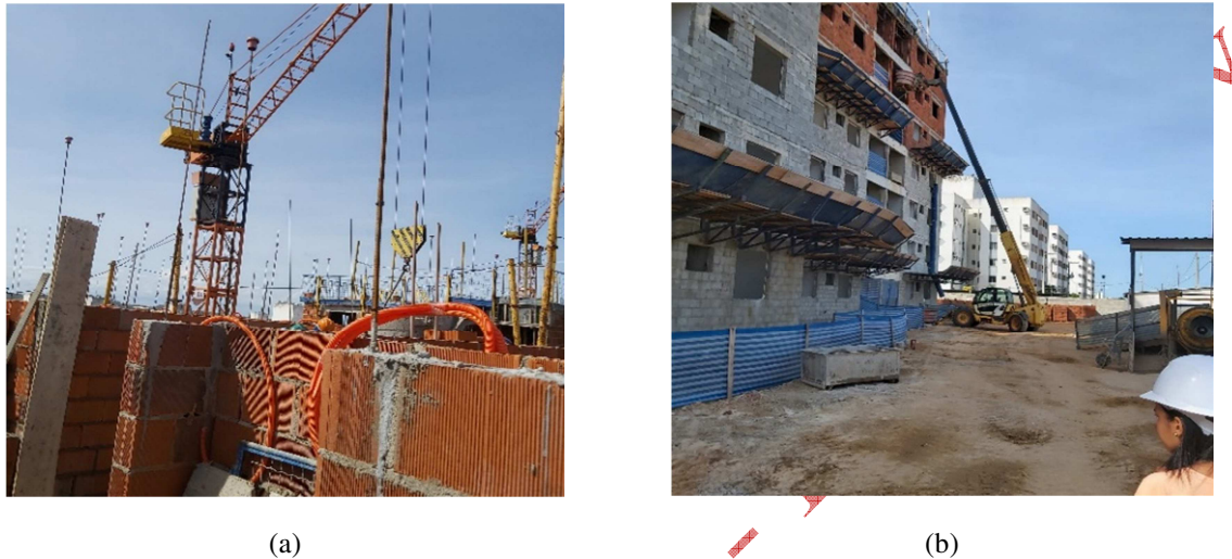
Figura 6 – Categoria facilitadora acesso. (a) Equipamento de transporte vertical; minigrua. (b) Equipamento de transporte horizontal e vertical: manipulador telescópico
