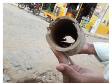
Figura 4. Estado de conservação da tubulação de cimento-amianto.
