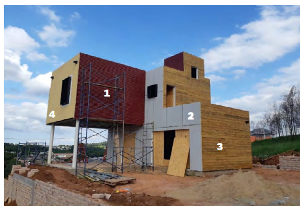
Figura 2 – Residência no sistema construtivo LSF. (1) telha metálica, (2) chapa cimentícia, (3) frontal de madeira e (4) manta líquida de vapor
