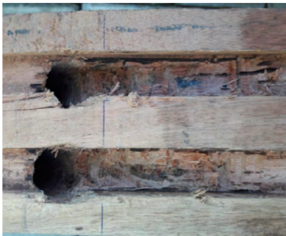
Figura 16 – Danos na interface de contato entre a madeira e o terminal prensado
