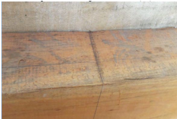
Figura 8 – Esmagamento do apoio no terço do comprimento da viga referência 2 (R2)
