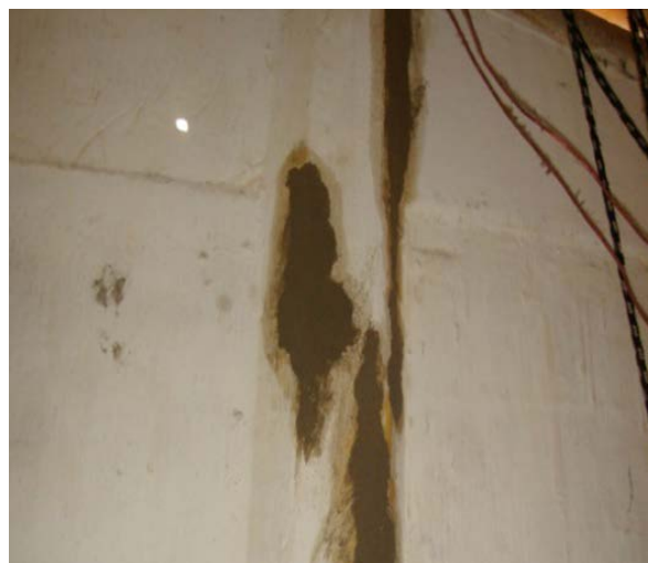
Figura 12 – Áreas com descolamentos do concreto em pilar, preenchidas com argamassa.
