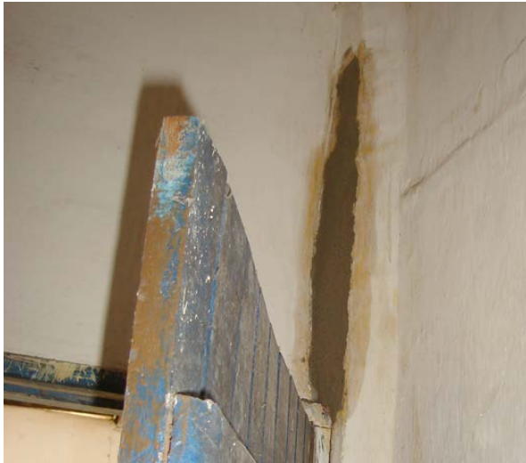
Figura 3 – Reparos nas juntas entre placas e pilares.
