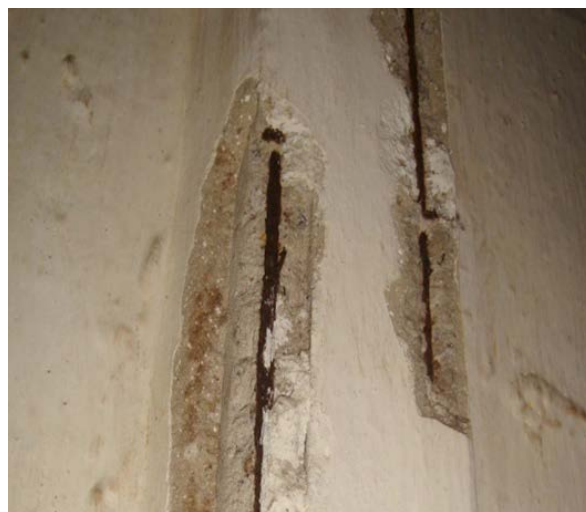
Figura 11 – Pilar com camada de concreto previamente descolada.
