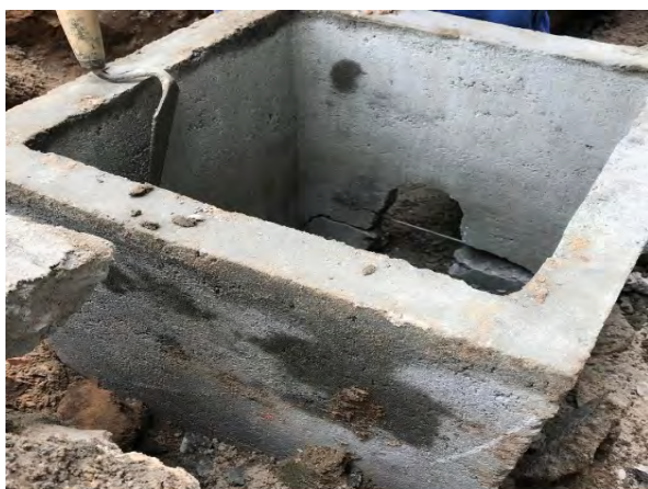
Figura 7 – Caixa danificada após abertura in loco na obra “A”
