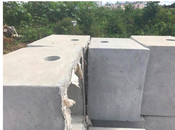
Figura 13 – Caixas de inspeção de ligação com aberturas na obra “C”
