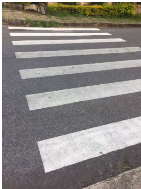
Figura 13 – Travessia de pedestres em desacordo com a normativa
