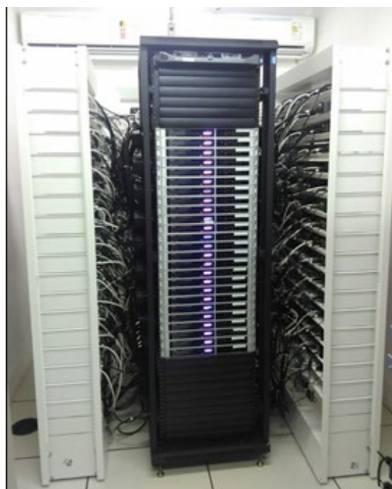
Figura 4 – Rack com 200 receptores DVB-C (nas laterais) e 25 encoders de vídeo com 8 entradas HDMI e saída TS/IP (no centro).
