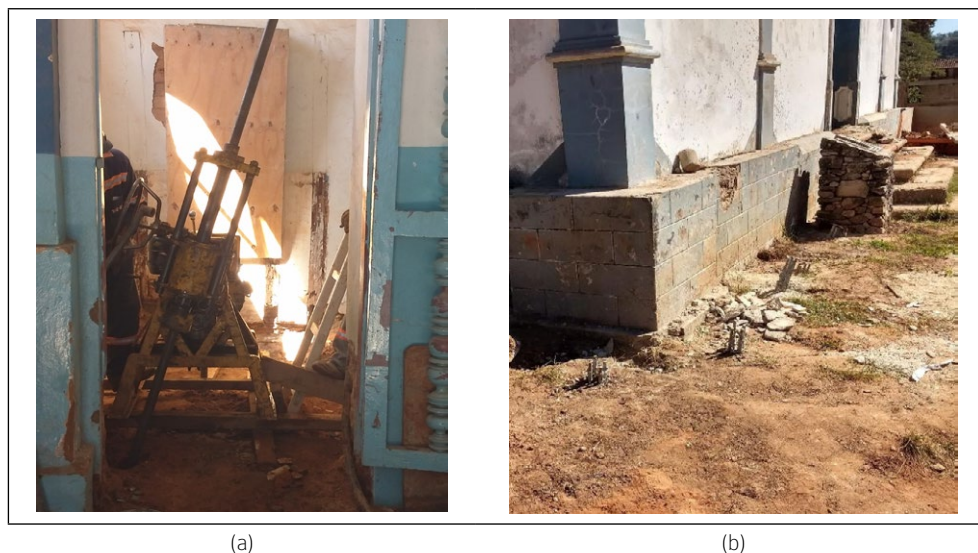
Figura 10 – (a) perfuratriz posicionada no interior da igreja e (b) estacas após a execução no exterior da igreja.
