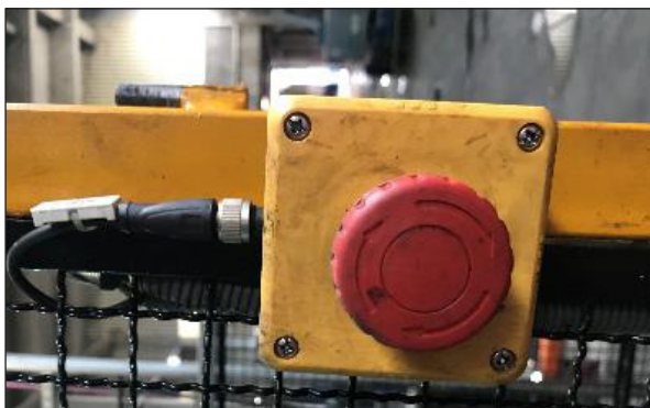
Figura 5 – Botão de emergência instalado na cilindrada
