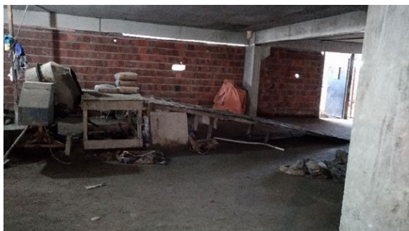
Figura 11 – Sacos de cimento próximo à betoneira em uso (obra da Construtora “E”)
