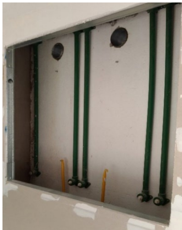
Figura 8 – Shaft para tubulações em local de fácil acesso (obra da Empresa “D”)
