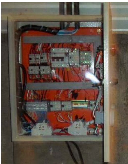
Figura 2 – Painel de comandos desenvolvido para o acionamento dos motores.
