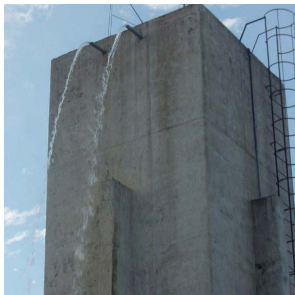
Figura 1 – Reservatório elevado com extravasamento.
