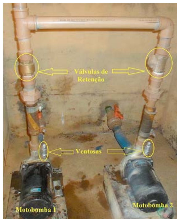
Figura 5 – Conjuntos motobombas com válvulas de retenção e ventosas instaladas.
