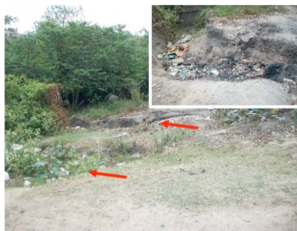
Figura 09 – Situação do terreno na base do talude. No detalhe, fenda vista de cima
