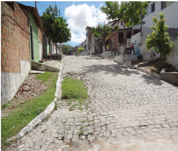
Figura 07 – Pavimentação da rua cedendo
