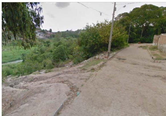
Figura 08 – Ruas pavimentadas e mata atlântica em parte do contorno do talude. A seta mostra o poste inclinado, indicando instabilidade do solo
