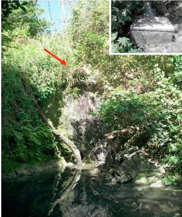
Figura 14 – A seta indica drenagem pluvial com presença de águas servidas. No detalhe, tubulação de esgoto sobre o topo da encosta
