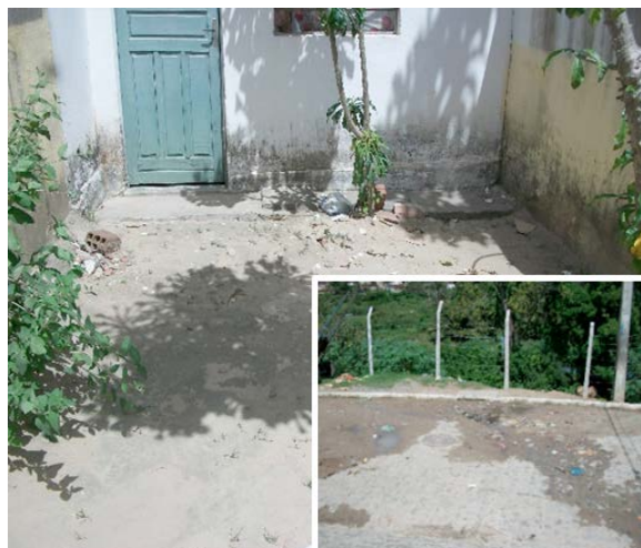
Figura 04 – Terreno sem drenagem. No detalhe, rede de esgoto também ineficaz
