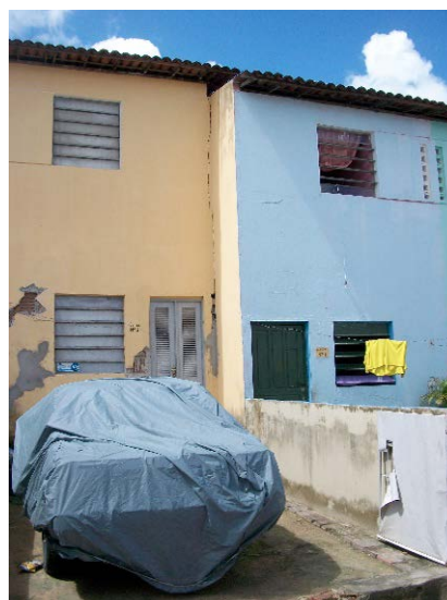
Figura 05 – Rachadura da cobertura à fundação
