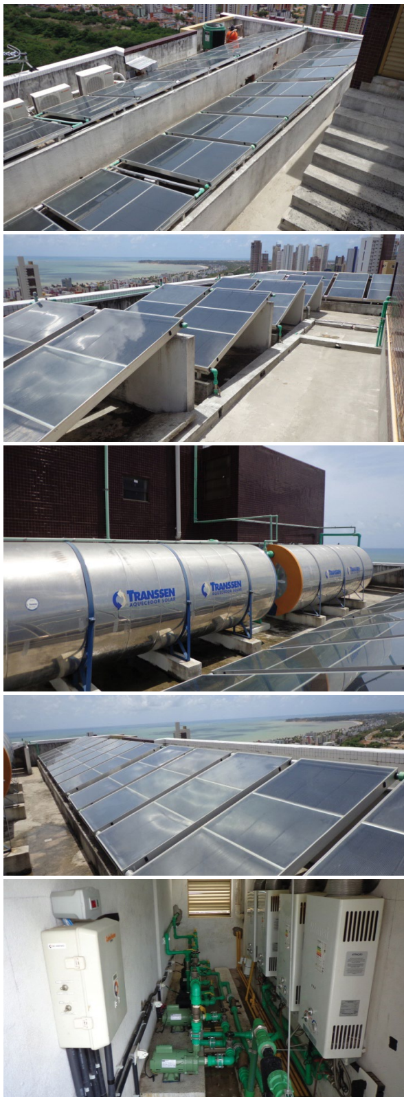
Figura 2 – Sistema de aquecimento solar real (coletores, reservatórios, bombas, aquecedores, controlador de temperatura automático).
