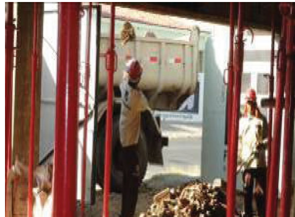
Figura 1 – Acúmulo de entulho em local de passagem.
