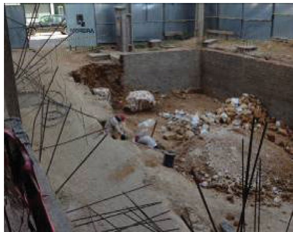
Figura 2 – Pontas de ferro sem proteção.
