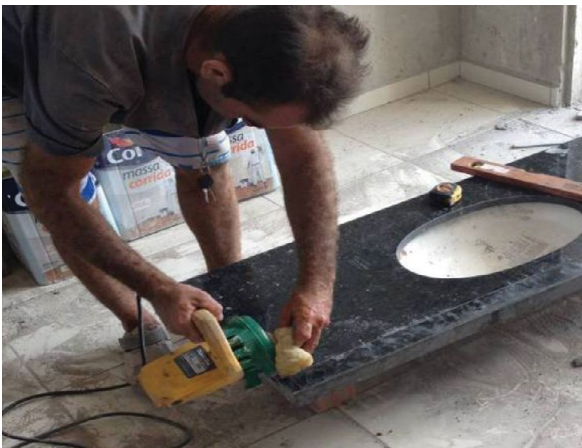
Figura 4 – Terceirizados sem qualquer tipo de EPI
