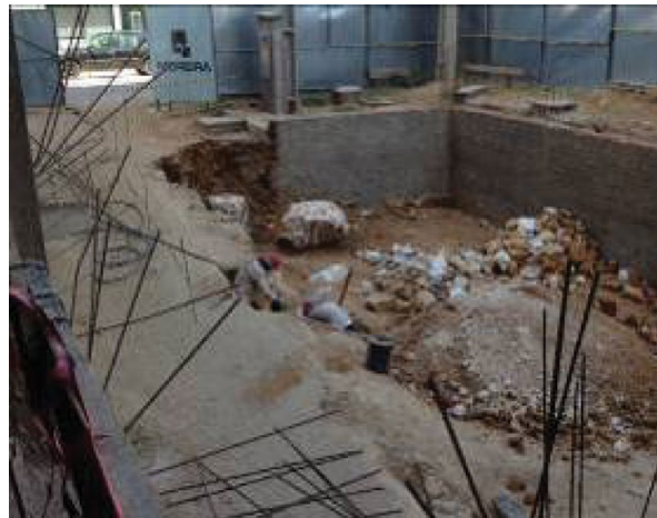
Figura 2 – Pontas de ferro sem proteção.
