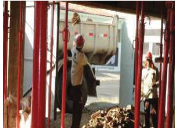
Figura 1 – Acúmulo de entulho em local de passagem.
