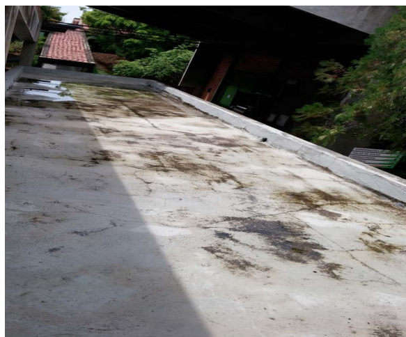
Figura 23 – Acúmulo de água pluvial sobre laje plana
