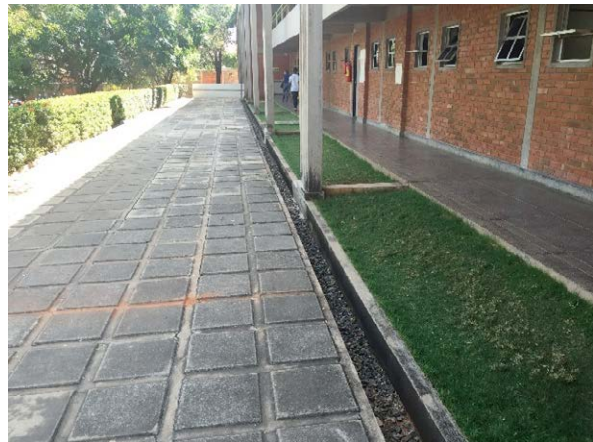
Figura 12 – Captação das águas pluviais por sistema de microdrenagem
