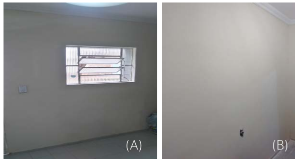
Figura 7 – (A) Parede 1 ( B) Parede 6, método de eletro-osmose
