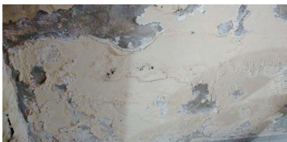
Figura 1 – Parede 1 com eflorescências, antes das intervenções
