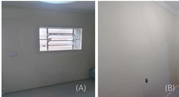
Figura 7 – (A) Parede 1 ( B) Parede 6, método de eletro-osmose
