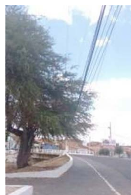
Figura 13 – Copa da árvore tocando a fiação elétrica na Praça Rolim Guimarães
