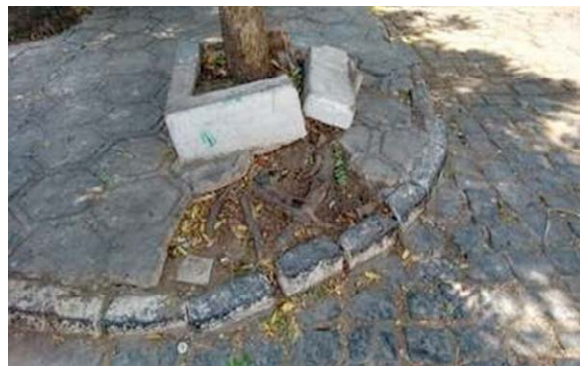
Figura 2 – Calçada danificada pelas raízes da árvore Azadirachta indica , na Praça Pedro Gondim
