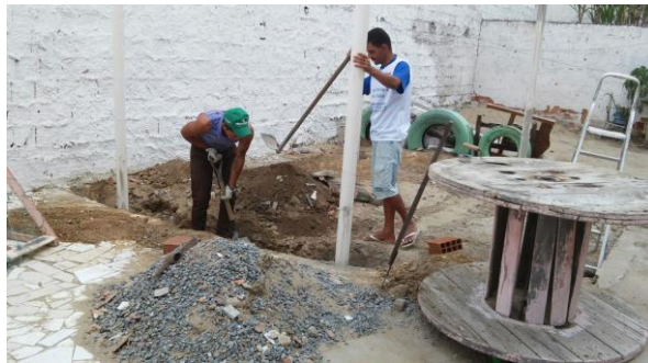
Figura 2 – Construção do espaço para o funcionamento da academia. Fonte: arquivo pessoal dos autores.
