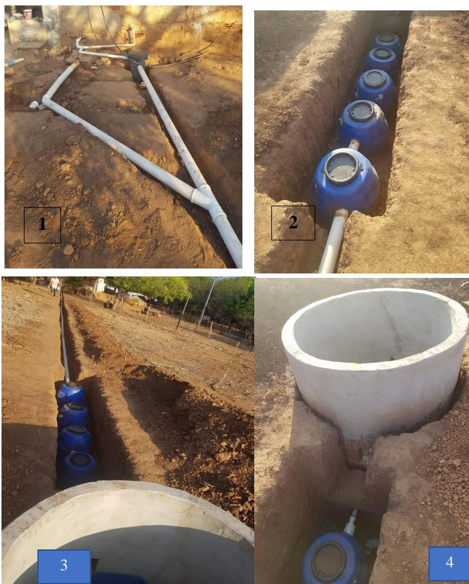
Figura 08 – Sistema instalado: (1) sistema de coleta de resíduos do esgotamento do banheiro e da cozinha, (2 e 3) sistema de bombonas com fossa séptica e filtro anaeróbio, (4) sistema de recepção do efluente após tratamento
