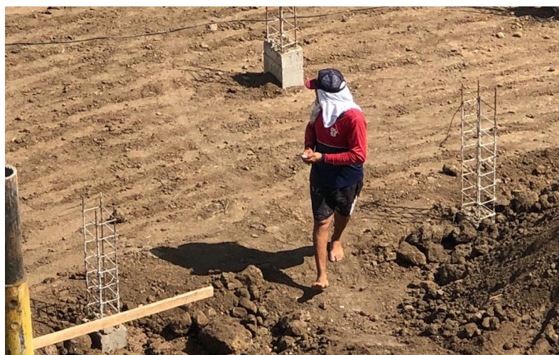
Figura 1 – Trabalhador transitando em canteiro sem o uso de botas, capacete e uniforme
