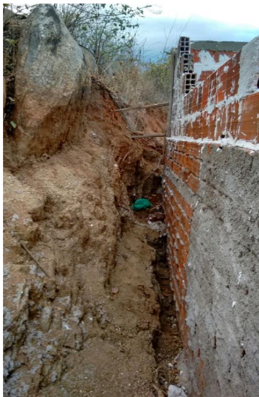
Figura 3 - Risco de desmoronamento Fonte: autoria própria
