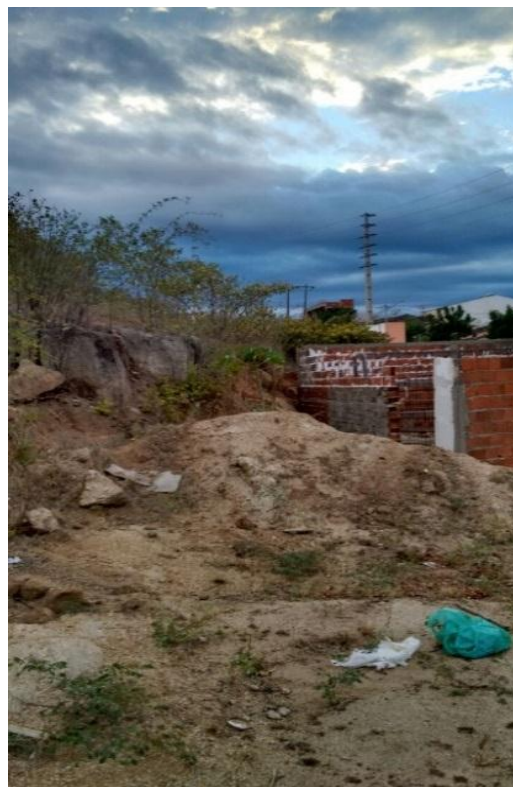
Figura 4 - Risco de desmoronamento Fonte: autoria própria
