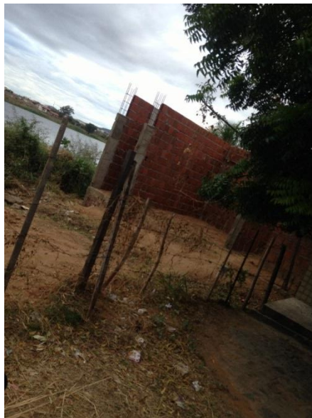
Figura 7 – Área Sujeita a inundação. Fonte: autoria própria
