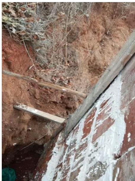
Figura 2 – Risco de desmoronamento. Fonte: autoria própria
