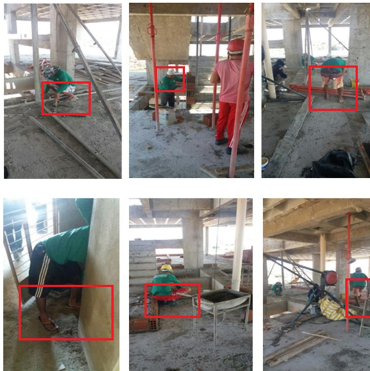
Figura 2 – Registro da ausência de entrega de EPI's a trabalhadores de edificação vertical no município de Cajazeiras – PB. Fonte: arquivo dos autores
