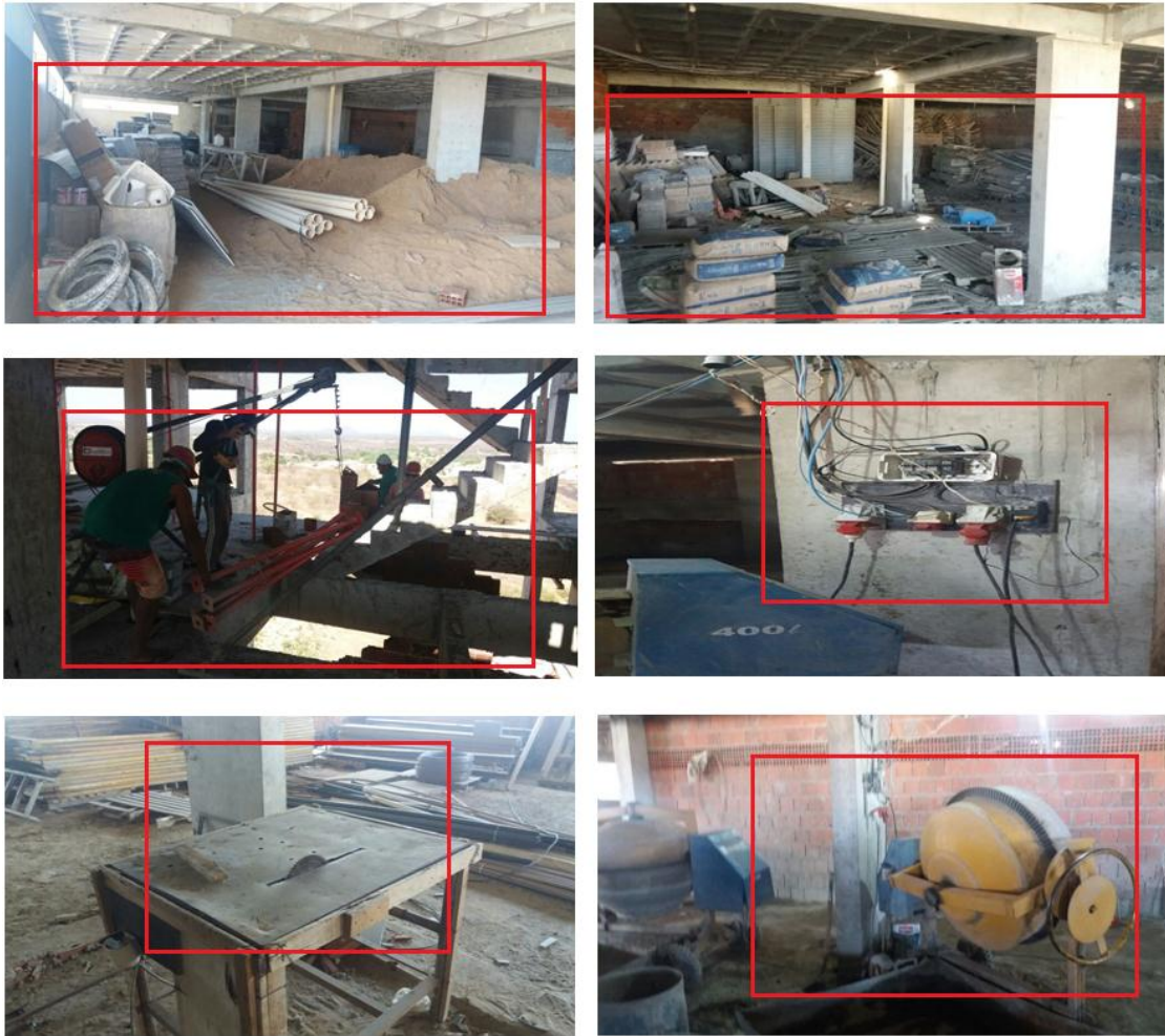
Figura 3 – Registro do armazenamento de materiais, das instalações elétricas provisórias e das condições de máquinas e equipamentos em edificação vertical no município de Cajazeiras – PB. Fonte: arquivo dos autores
