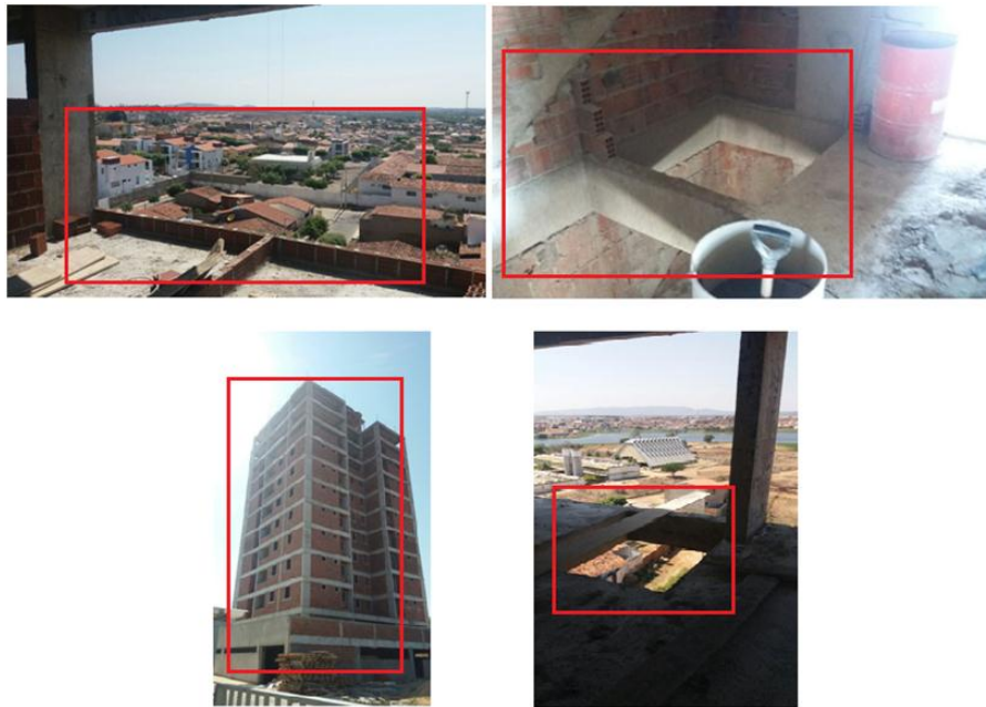
Figura 1 – Registro da ausência de medidas de proteção contra quedas em uma edificação vertical no município de Cajazeiras – PB. Fonte: arquivo dos autores
