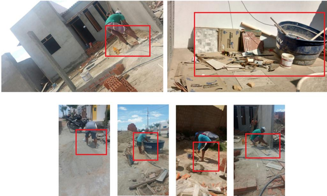
Figura 4 – Registro das condições gerais de trabalho em uma obra de edificação térrea no município de Cajazeiras – PB. Fonte: arquivo dos autores
