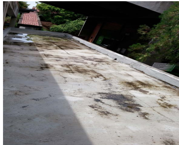
Figura 23 – Acúmulo de água pluvial sobre laje plana
