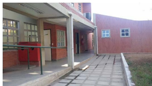
Figura 17 – Lançamento de águas pluviais diretamente sobre superfície impermeável (acesso ao refeitório)
