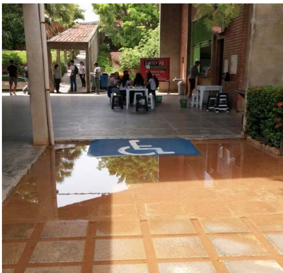
Figura 21 – Acúmulo de águas pluviais advindas de telhados adjacentes à circulação externa
