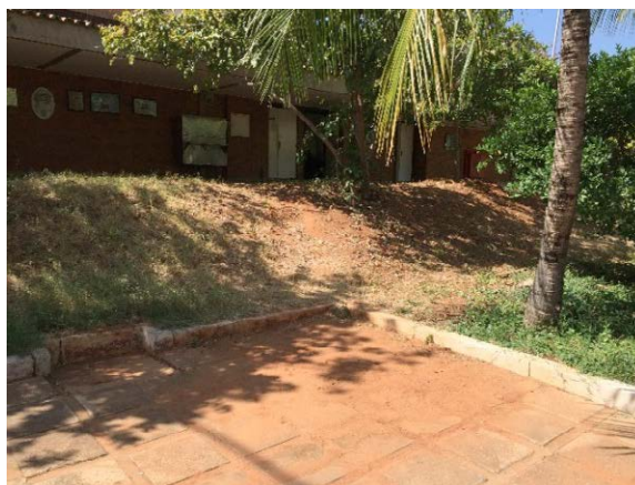
Figura 20 – Área de circulação após plano inclinado e detalhe para o carregamento de sedimentos, respectivamente
